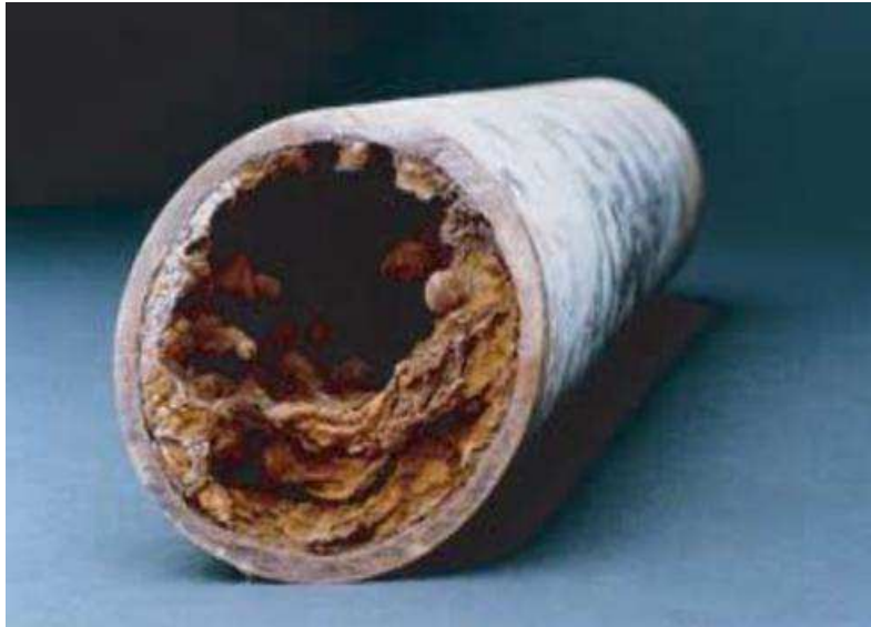
Figura 2.7: Tubería afectada por Corrosión microbacteriana [7].
