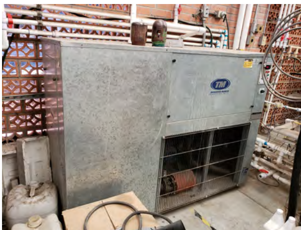
Figura 3.24: Chiller de 5 toneladas de refrigeración para enfriamiento del equipo
