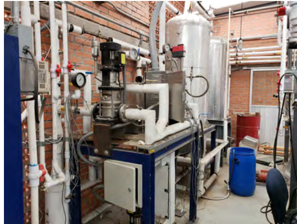
Figura 3.23: Sistema de calentamiento; bomba, resistencia y tanque de almacenamiento
