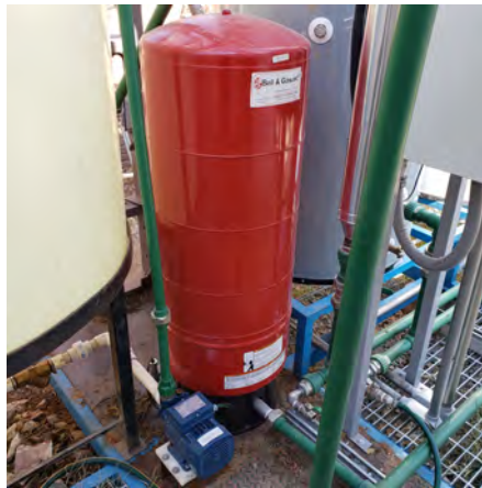
Figura 5.7: Tanque de expansión
