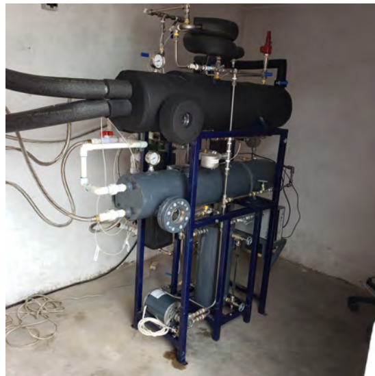
Figura 5.15: Instalación final del sistema
