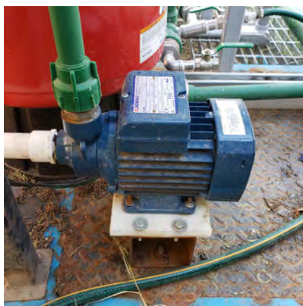
Figura 5.12: Bomba de agua helada
