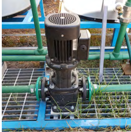
Figura 5.9: Bomba para el agua caliente
