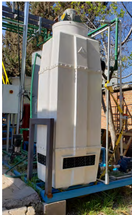
Figura 5.2: Torre de enfriamiento Delta T
