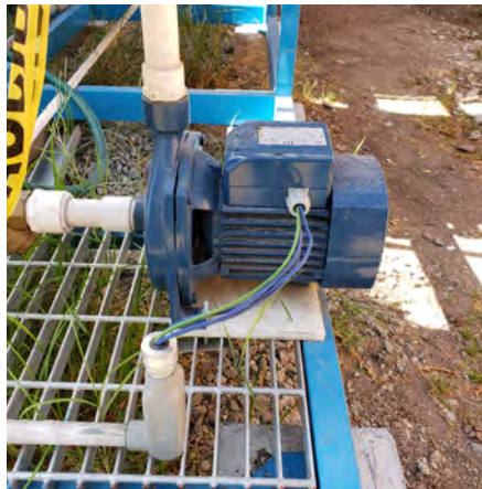
Figura 5.4: Bomba de agua de enfriamiento
