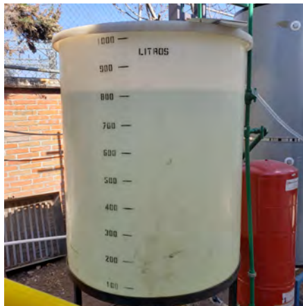
Figura 5.10: Tanque de agua helada
