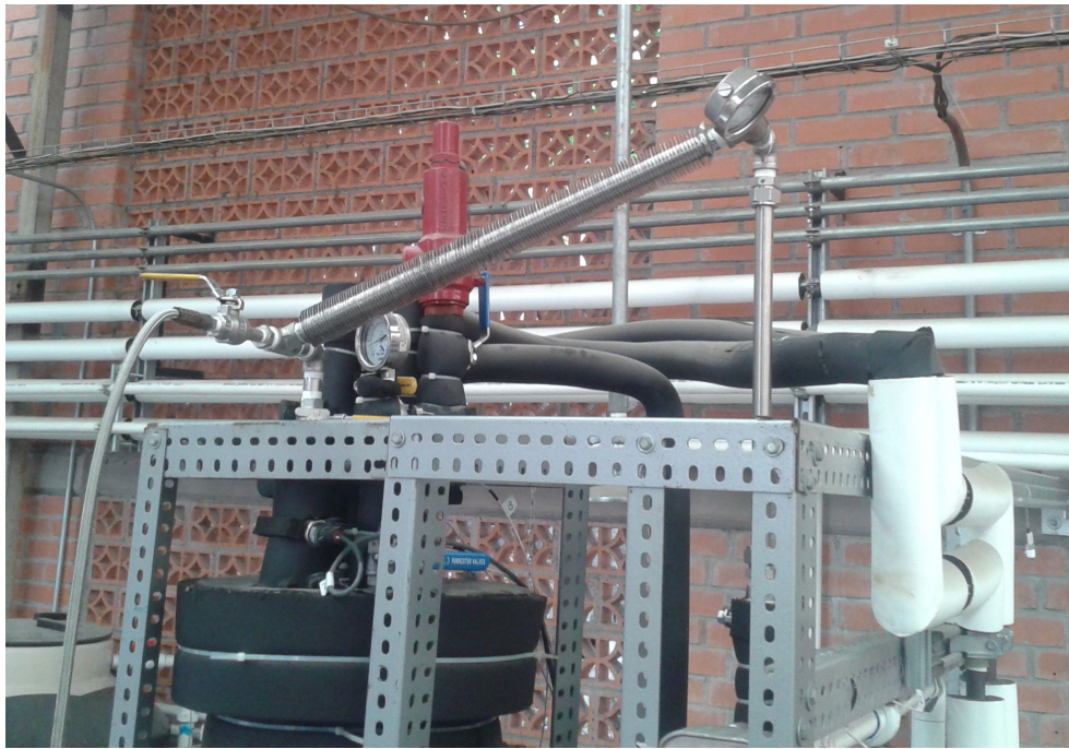
Figura 3.10. Fotografía del rectificador acoplado al refrigerador
