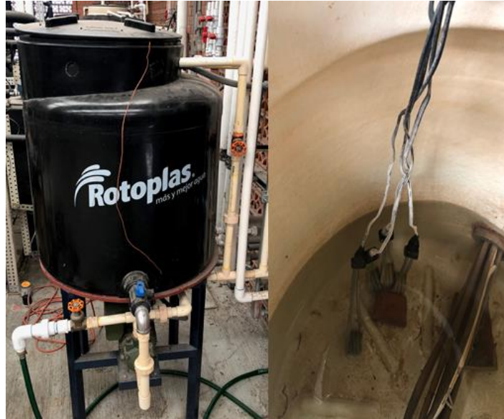
Figura 3.27. Tanque de almacenamiento de agua enfriada, junto con sus resistencias eléctricas y bomba.
