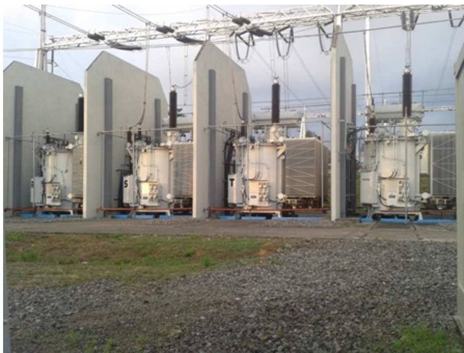
Figura 8: Banco de Transformación, un transformador por fase y uno de reserva
