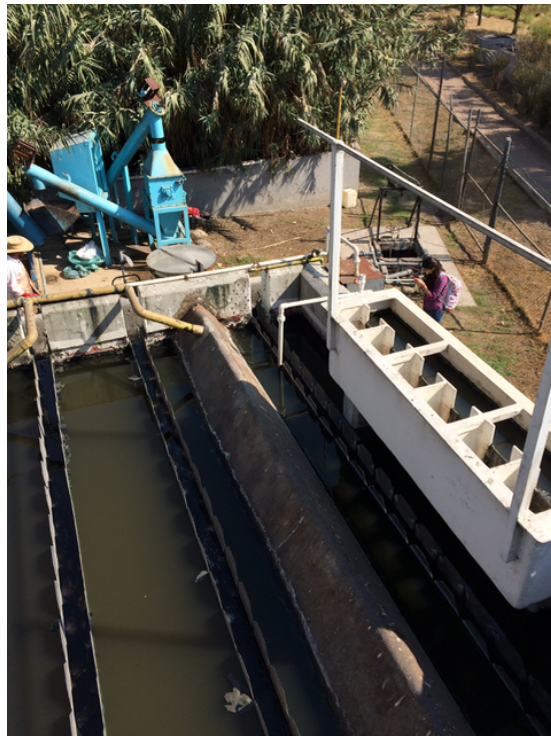
Figura 13. Reactor UASB y tornillo en planta piloto FORSU.
