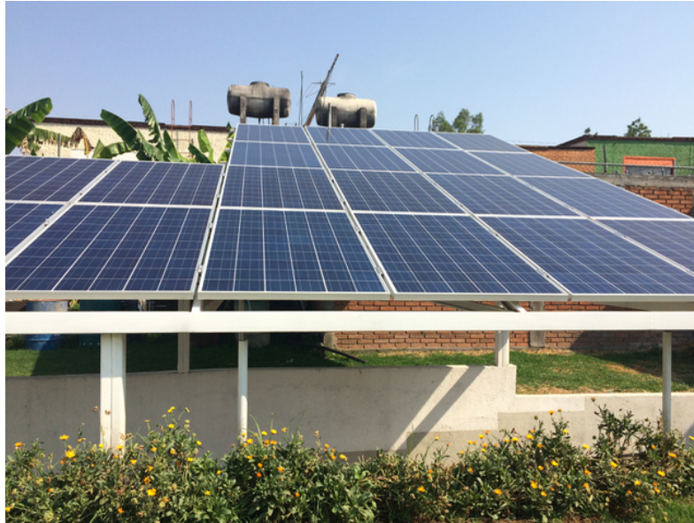
Figura 10. Paneles fotovoltaicos en planta Aguas Residuales.
