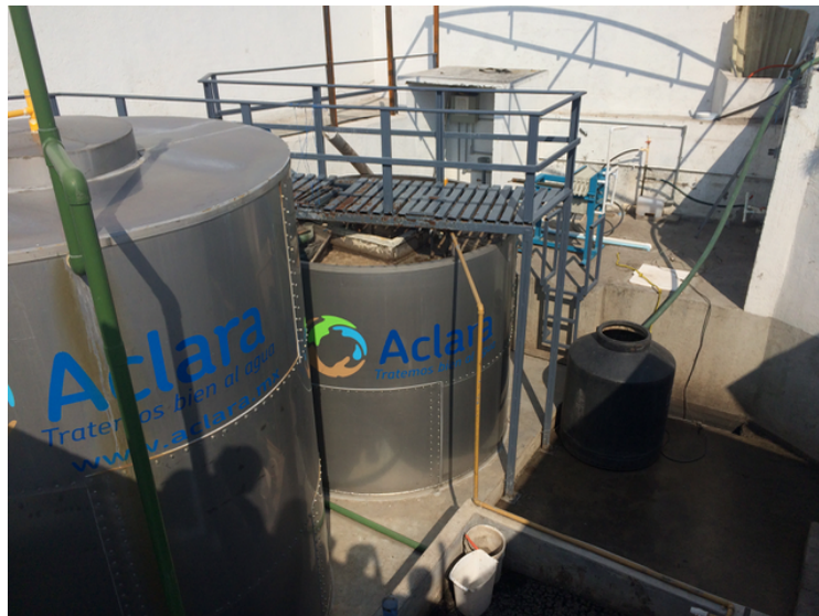
Figura 9. Reactor UASB y reactor aerobio de lodos activados en planta Aguas Residuales.
