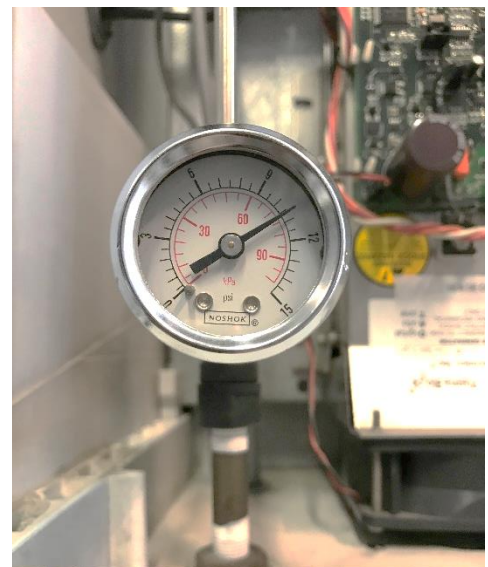
Figura 19. Manómetro de entrada al generador de ozono.
