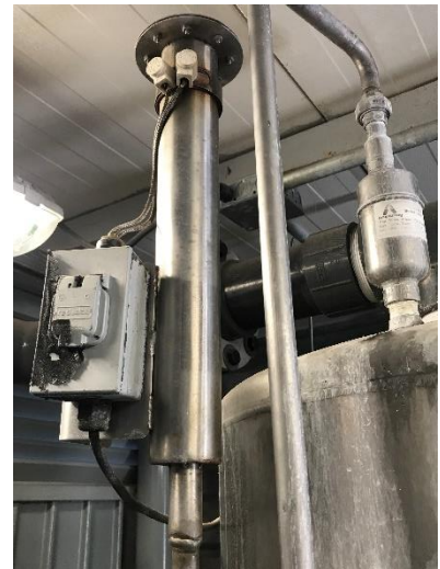
Figura 15. Destructor de ozono.
