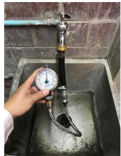
Figura 24. Manómetro adaptado para la medición de presiones en los edificios.
