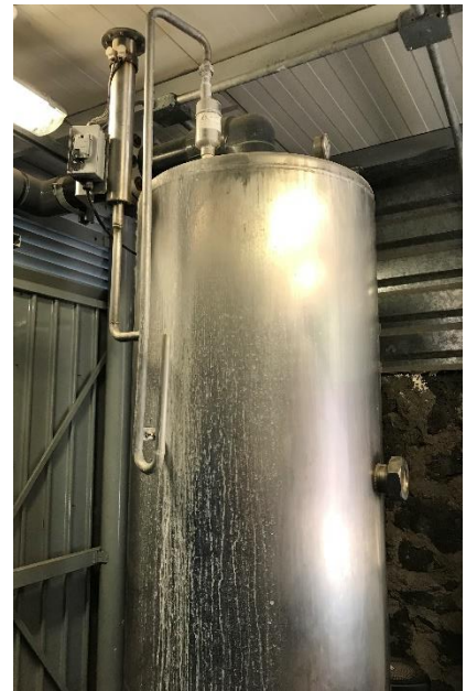
Figura 39. Tubería que conduce al destructor de ozono y derivación para expulsar agua.
