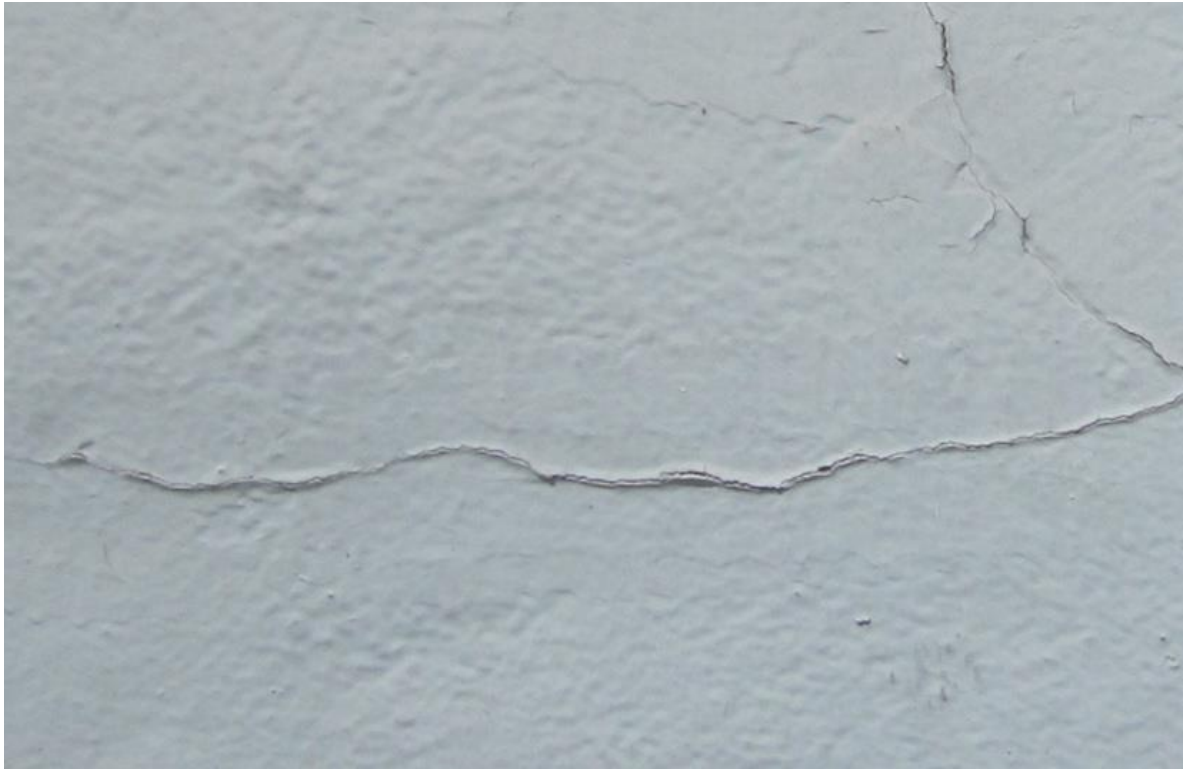
Imagen 37. Daño ligero en un muro.
