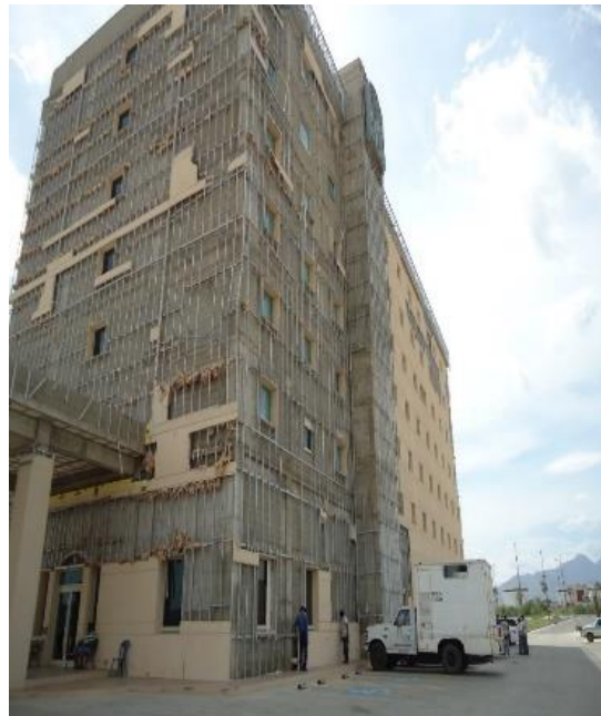
Figura 1.5 Desprendimiento de la fachada en un hotel durante el huracán Odile (2014)
