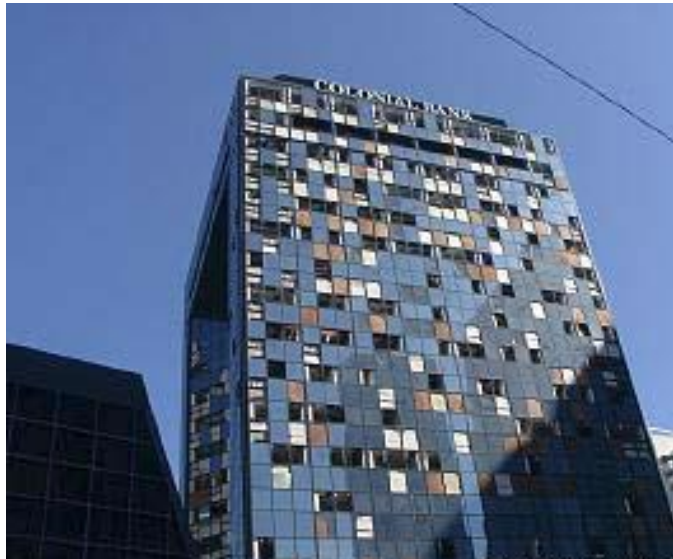
Figura 1.4 Daños en los cristales debido a los efectos del huracán Wilma (2005), Miami Florida
