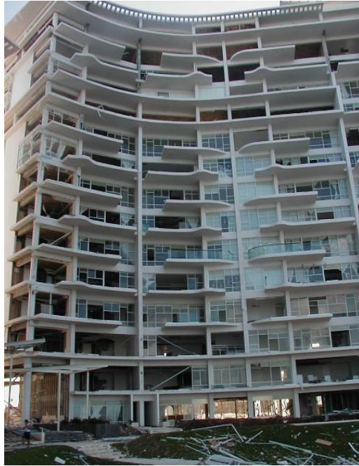
Figura 1.3 Daños debidos al huracán Wilma (2005) en la ciudad de Cancún
