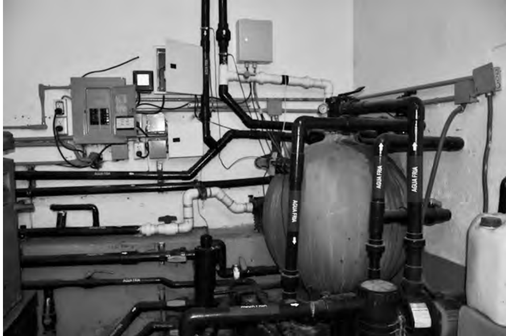
Figura 5.34: Cuarto de máquinas de la alberca: lugar donde se encuentra instalado el sistema de monitoreo.
