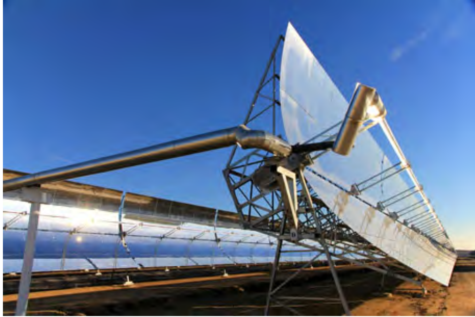
Figura 1.6: Planta termosolar Agua Prieta II Sonora.
