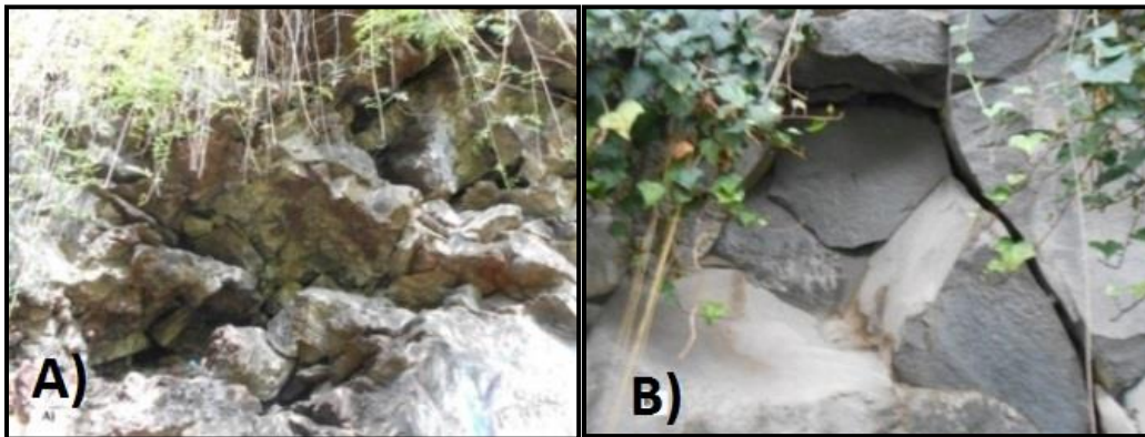
Figura 35.- A y B Muestran algunas grietas que presenta la barda de roca volcánica que son los lugares de acceso y refugio con los que cuentan los murciélagos. Fotos tomadas por Yezenia G. Bermúdez.
