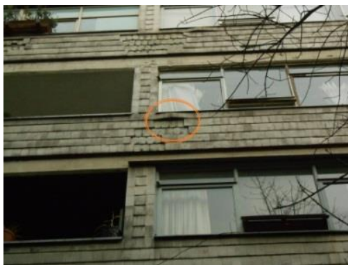
Figura 22.- Se muestran las tejas desprendidas del edificio donde se vieron salir a los murciélagos encerrada en un círculo naranja. Foto tomada por Yezenia G. Bermúdez.
