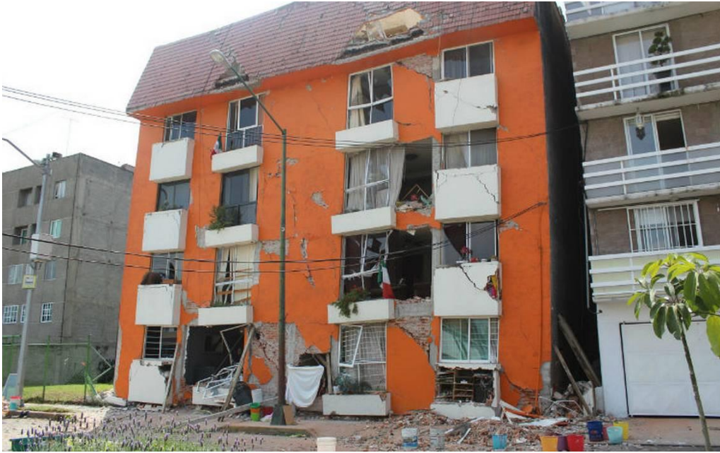
Figura 3.12 Colapso de las viviendas de 5 pisos en Paseos de las Galias y Av. Tláhuac después del sismo de M7.1. ( http://bit.do/d3u65 )
