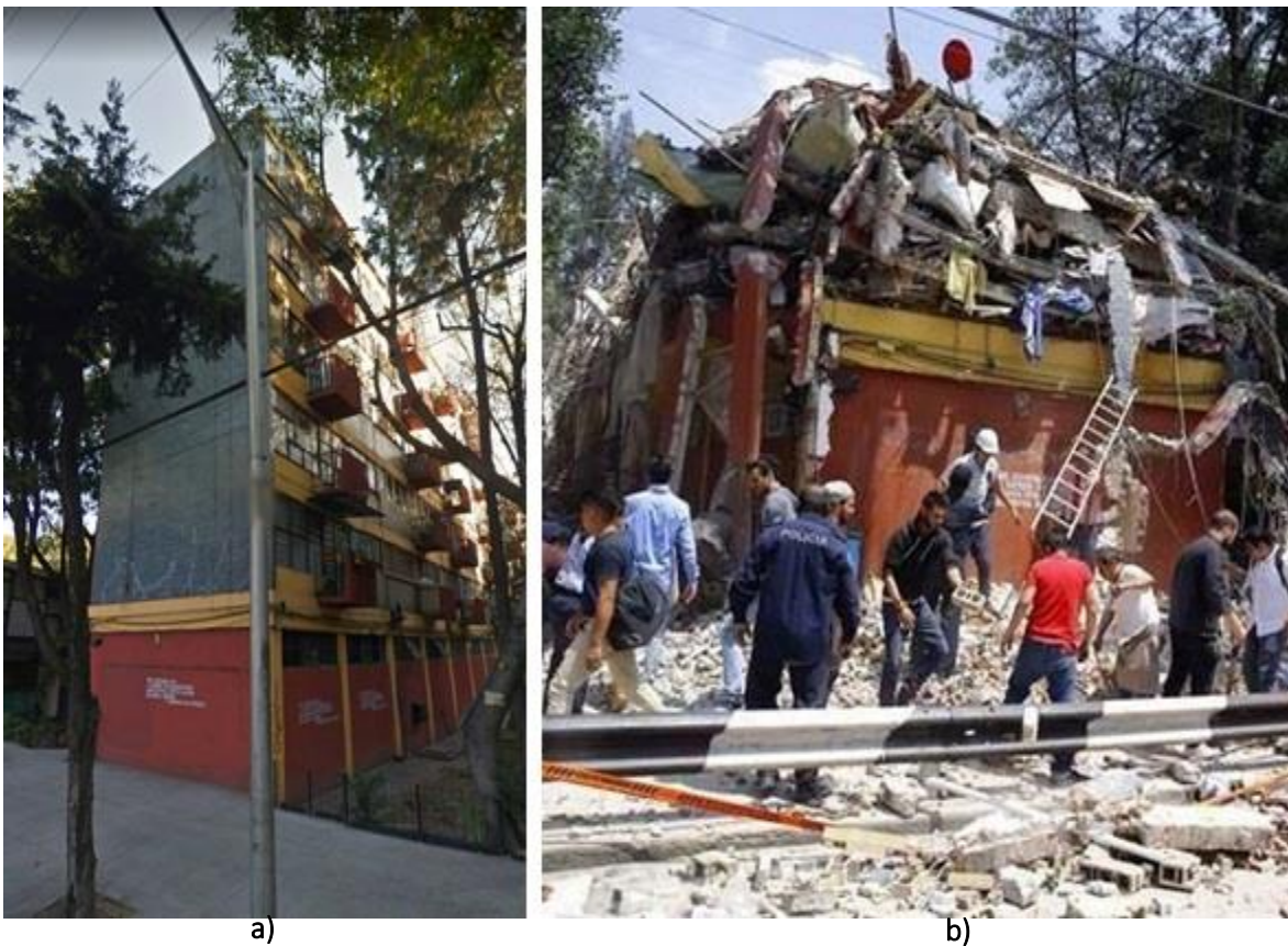
Figura A. 21 Edificio en Calzada de Tlalpan: a) antes del evento sísmico y b) después del evento sísmico de M7.1 ( http://bit.do/d3u65 )
