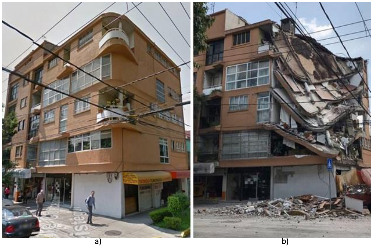
Figura A. 5 Edificio en Concepción Beistegui & Calle Yacatas Eje 2 poniente, Calle Gabriel Mancera y Escocia: a) antes del evento sísmico y b) después del evento sísmico de M7.1 ( http://bit.do/d3u65 )
