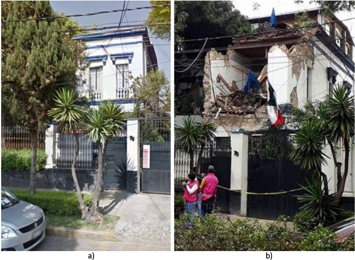
Figura A. 29 Edificio en Cuauhtémoc No. 75, a) antes del evento sísmico y b) después del evento sísmico de M7.1 ( http://bit.do/d3u65 )
