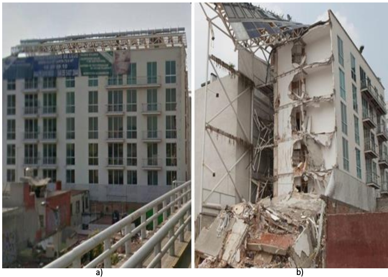
Figura A. 19 Edificio en Emiliano Zapata No. 56: a) antes del evento sísmico y b) después del evento sísmico de M7.1 ( http://bit.do/d3u65 , http://bit.ly/2DzhsrX )
