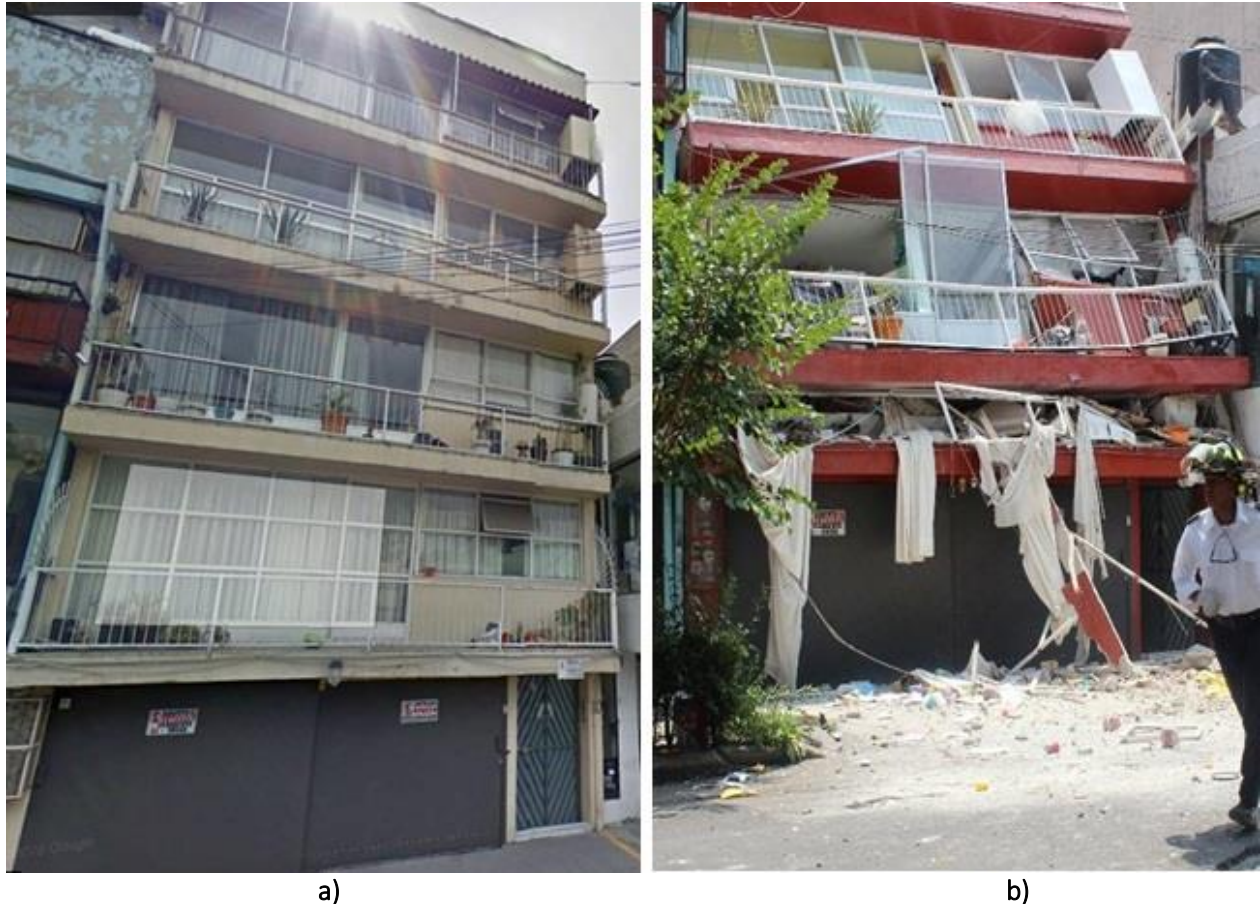
Figura A. 28 Edificio en Coahuila No. 8: a) antes del evento sísmico y b) después del evento sísmico de M7.1 ( http://bit.do/d3u65 )
