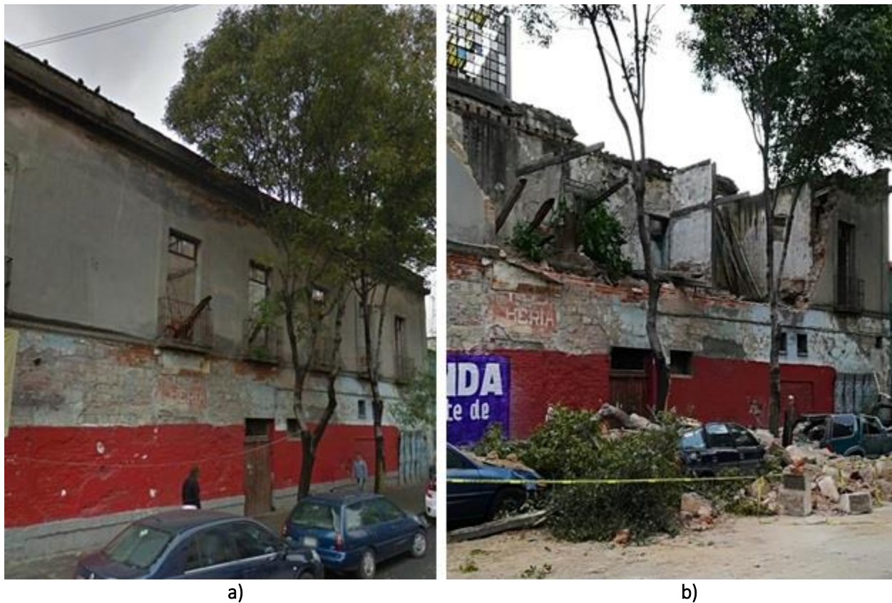
Figura A. 20 Edificio en Magnolia esq. Lerdo: a) antes del evento sísmico y b) después del evento sísmico de M7.1 ( http://bit.do/d3u65 )
