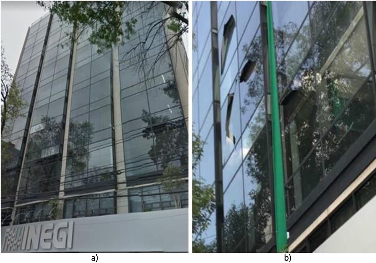
Figura B. 7 Edificio en Baja California Sur y Nuevo León, a) antes del evento sísmico y b) después del evento sísmico de M7.1 ( http://bit.ly/2DSb8uS )
