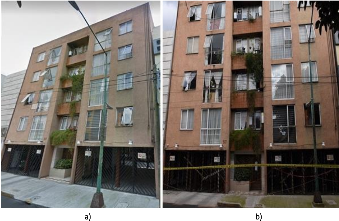
Figura A. 36 Edificio en Tokio No. 517: a) antes del evento sísmico y b) después del evento sísmico de M7.1 ( http://bit.ly/2GdOLOM )
