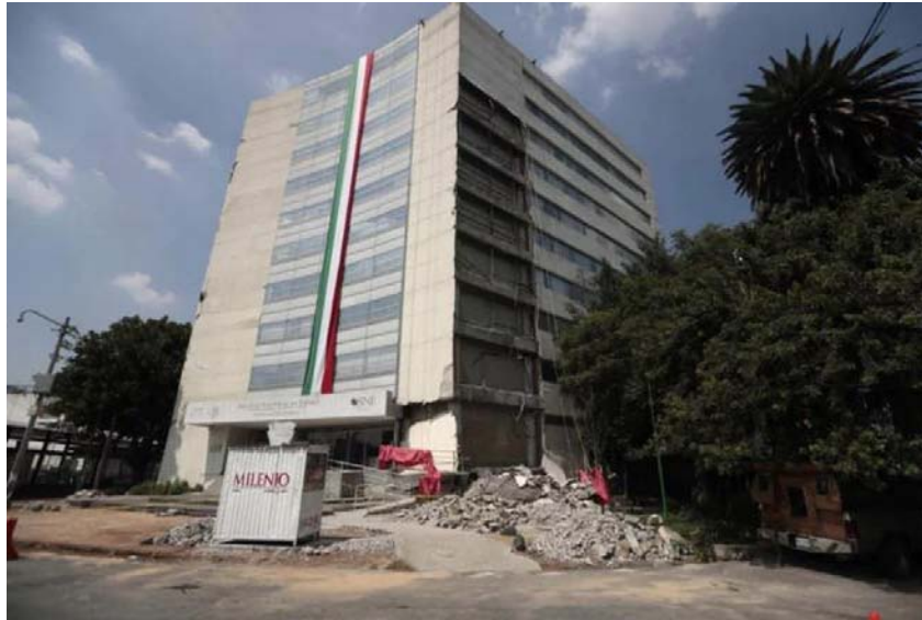
Figura 3.10 Falla de fachada edificio Servicio Nacional del Empleo 10 pisos CDMX ( http://bit.ly/2DKs7Qv ).
