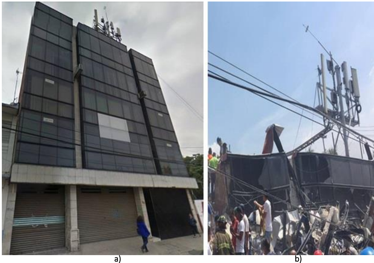
Figura A. 11 Edificio Bolívar No. 168: a) antes del evento sísmico y b) después del evento sísmico de M7.1 ( http://bit.do/d3u65 )
