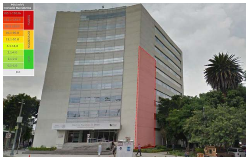
Figura 3.9 Falla de fachada edificio Servicio Nacional del Empleo 10 pisos CDMX (Dr. Miguel Ángel Jaimes Téllez 2017)
