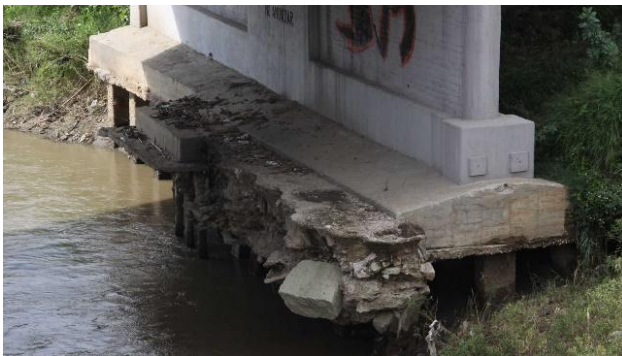
Figura 3.11 Socavación de la cimentación de puente vehicular en Oaxaca (“IV Centenario: el puente roto | Noticiasnet”, s/f)
