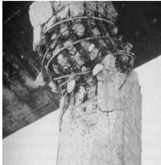
Figura 2.2 Falla por cortante dentro de la zona de articulación plástica en el terreno de San Fernando (Priestley et al., 1996)
