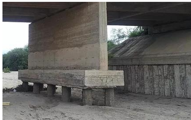
Figura 3.8 Subestructura de puente socavando del sistema carretero nacional(GIPSA INGENIERIA S.A. de C.V., 216d. C.)
