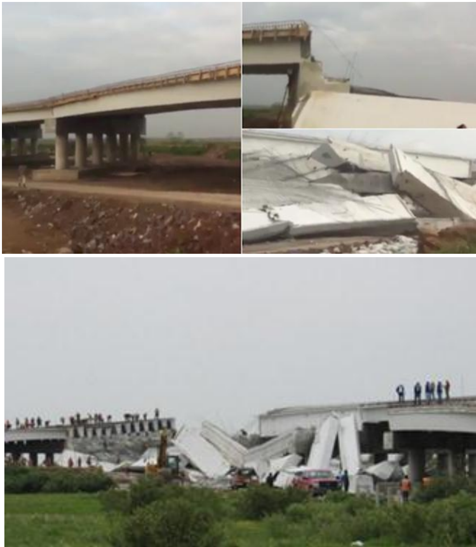
Figura 2.9 Puente vehicular de la Autopista Pirámides-Texcoco; colapso de viga tipo ASHTO, debido a mala conexión con el cabezal.
