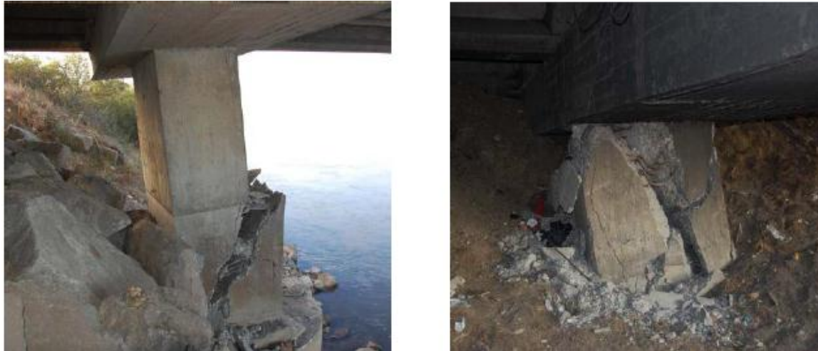
Figura 2.7 Falla de las columnas por cortante en sismo de Chile 2010 (Barriga, 2011)
