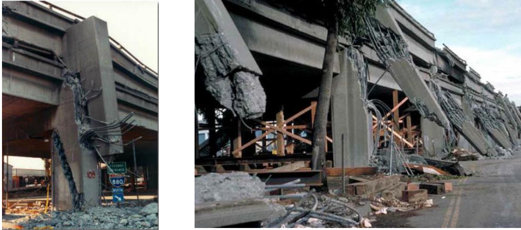
Figura 2.3 Falla en la unión de traslape en la base de la columna. (Barriga, 2011)
