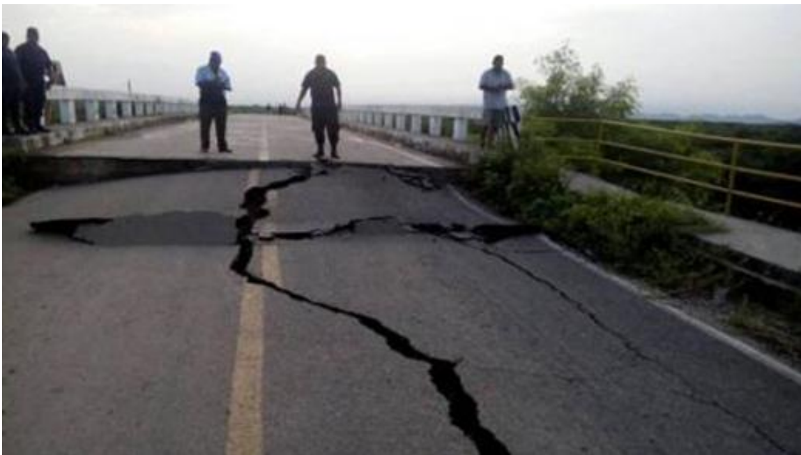
Figura 2.8 Puente Estero, Oaxaca: Falla de talud de acceso
