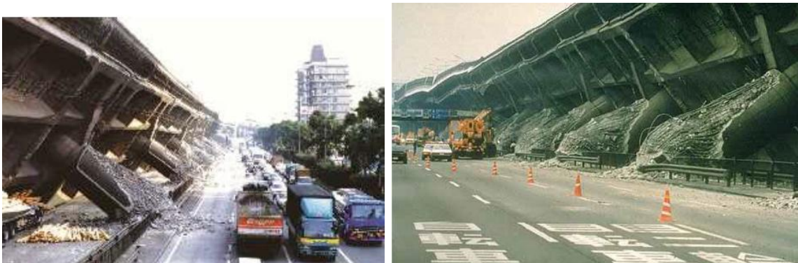
Figura 2.4 Falla a flexión en la base de las columnas del puente Hanshin (Díaz, J. , 2011)
