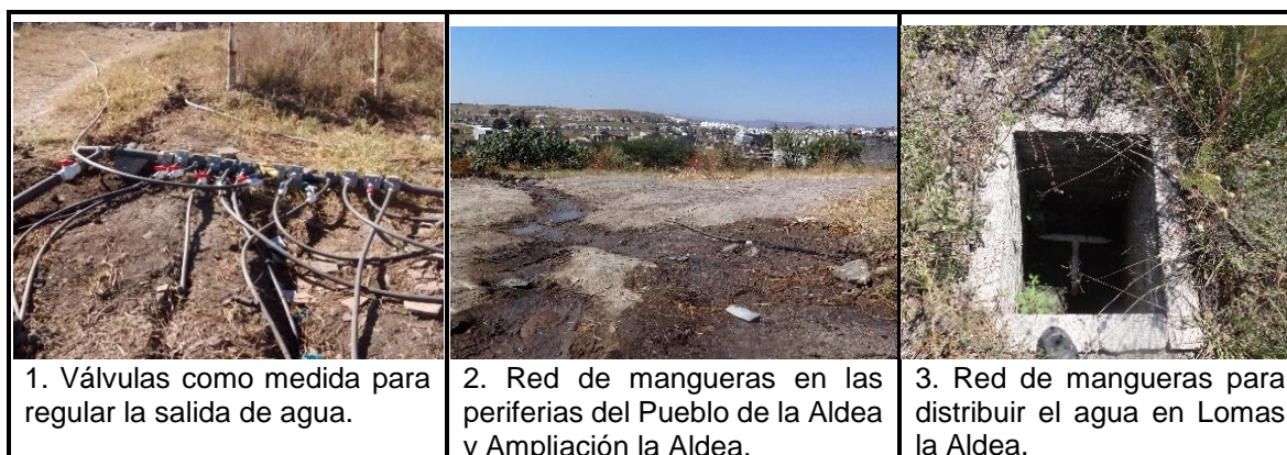
Figura 4.15. Infraestructura y equipo utilizado para distribuir el agua. Fuente: Elaboración propia.
