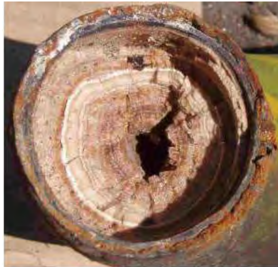
Figura 6, Incrustaciones de sales en tubería de acero (MERUS, 2018)
