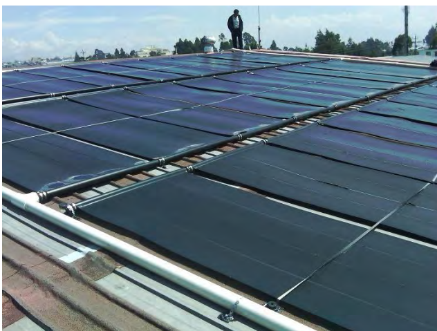
Ilustración 22 Mantas de polipropileno para calentamiento de piscinas.
