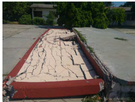
Figura 6. En el temblor del 2017 el Muro se vino abajo.
