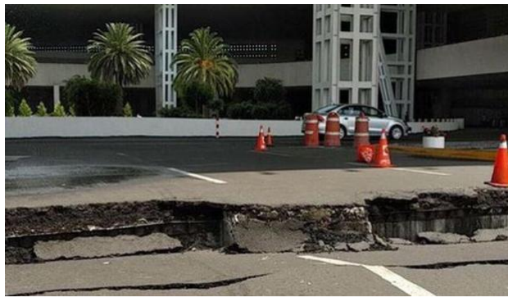
Fig. I.14 Grieta en la entrada de la Terminal 2 del AICM provocada por el sismo( Imagen de "zocalo.com.mx")
