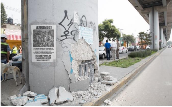
Fig. I.13 Columna del Viaducto elevado de la Línea 12 del metro dañada por el sismo del 19 de septiembre (Imagen de "El Universal")
