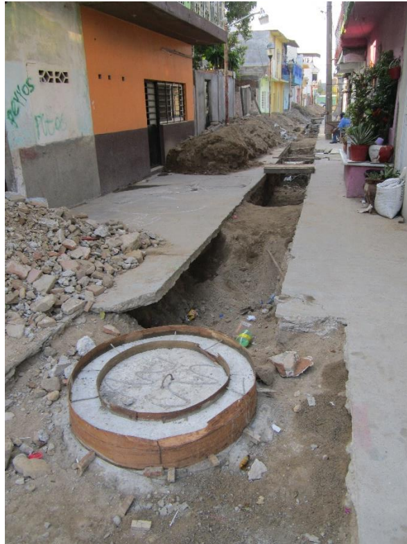
Figura 9. Reparaciones en una línea de drenaje, Salina Cruz, Oaxaca
