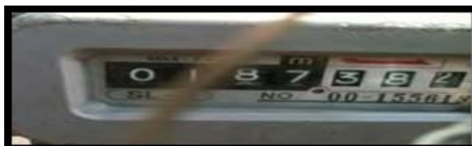
Figura 3.10 Medidor de gas (Grimaldo, 2013)
