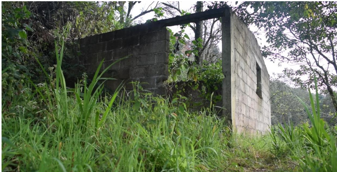
Figura 4.5 Vivienda dañada por procesos de remoción en masa en la colonia La Juárez (d).
