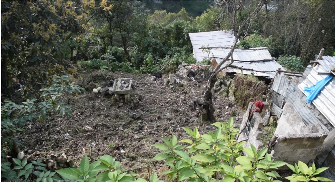
Figura 4.4 Afectación a vivienda por inestabilidad de laderas en la colonia Lindavista (c).
