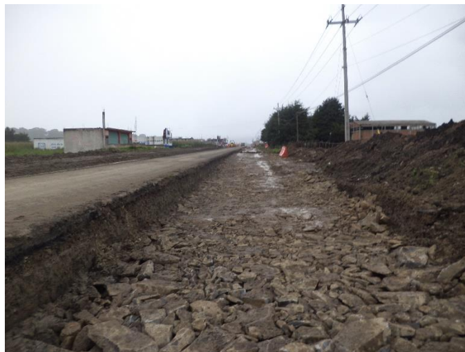
Figura 5.4 Extendido y acondicionamiento de humedad en carretera Villa Victoria – San José del Rincón
