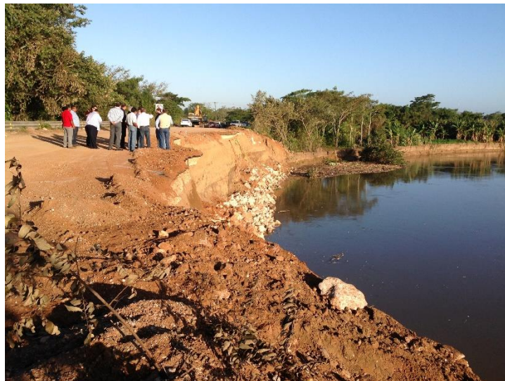
Falla de Terraplén
