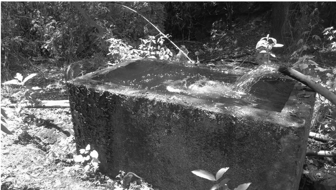
Figura 24. Pila de agua hecha de concreto para almacenar agua y distribuirla por gravedad hacia las mangueras que salen del lado izquierdo.
