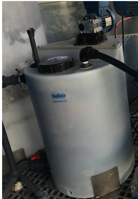
Figura 2.4 Tanque de homogeneización de co-sustrato.
