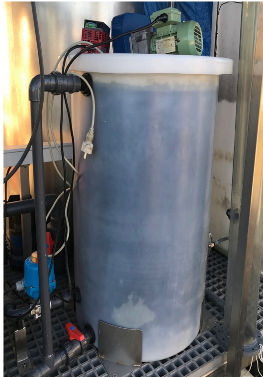
Figura 2.11 Tanque de salida.
