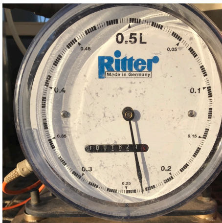
Figura 2.8 Medidor de gas.
