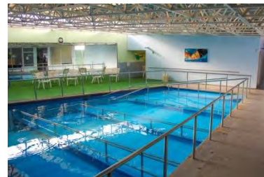
Fotografía 1.7 Instalación de Tanque Terapéutico by NHG Hospital de la columna vertebral León Gto.
