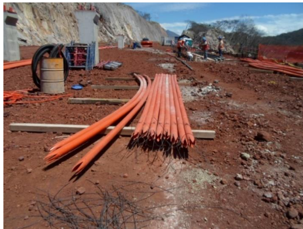
Fotografía 5. Funda de protección del ancla.
