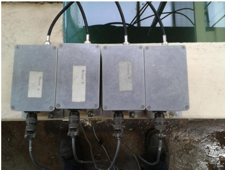
Figura 3.13 Acondicionadores que se conectan a los sensores de nivel
