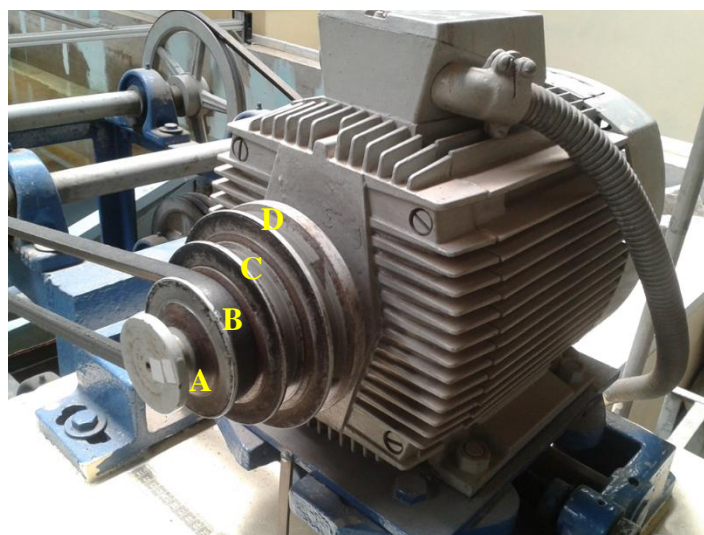
Figura 3.19 Poleas adosadas al motor eléctrico del estanque de olas
