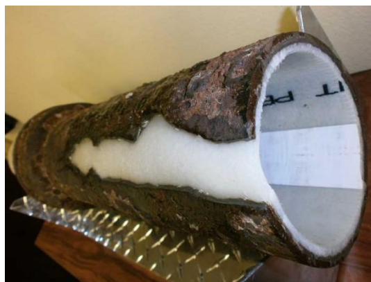
Figura 7 Re entubado de una línea dañada. Fuente: Broken sewer pipe Chicago & Company (2002)
