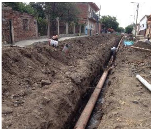
Figura 3 Excavación de zanja en zona urbana. Fuente: gaceta municipal de techalutla, Jalisco (2014)
