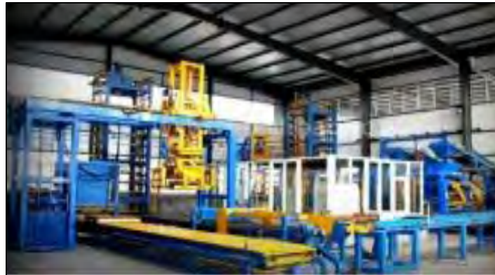
Figura 1.3 Central de producción de prefabricados de concreto (Corzo y Cuatin, 2011)
