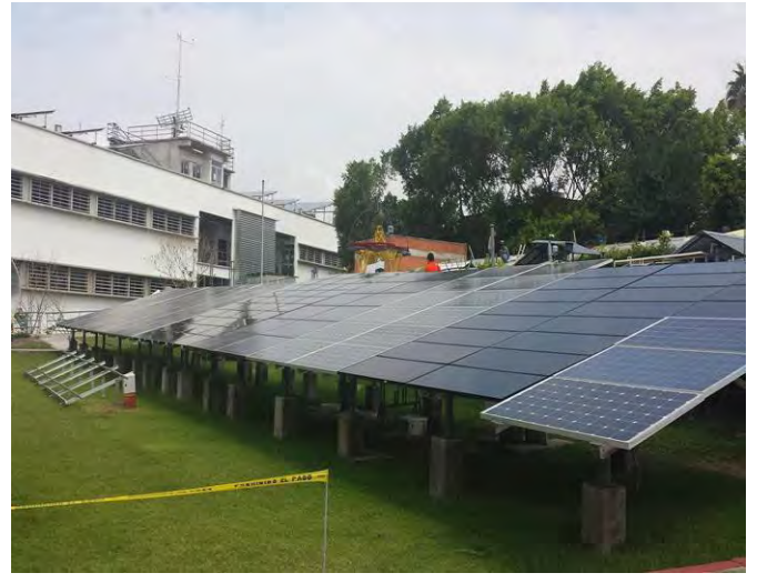
Figura 19 Instalación completa de la Plataforma SFV
