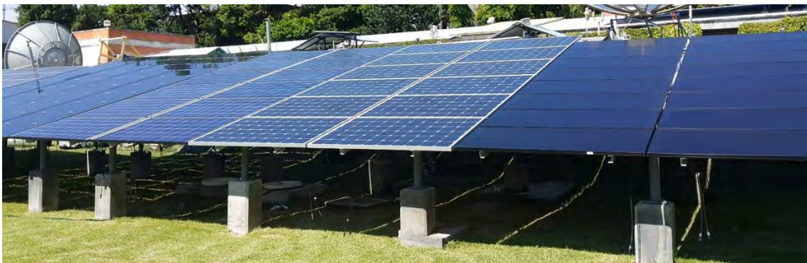
Figura 23 Plataforma solar FV en operación
