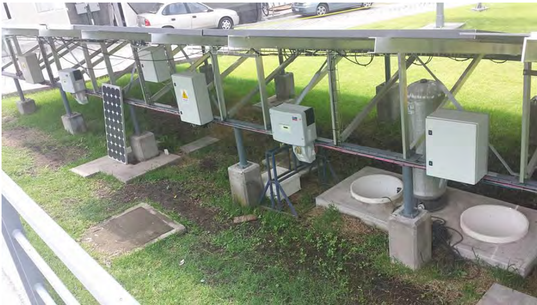
Figura 20 Ubicación de cajas de combinación, Sistema de monitoreo e inversores
