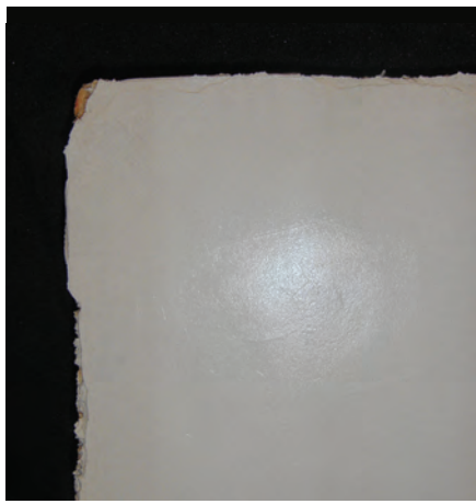
Fig. 12 Detalle de enlucido húmedo
