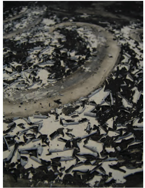
Fig. 99 Detalle donde se nota el desprendimiento del temple
