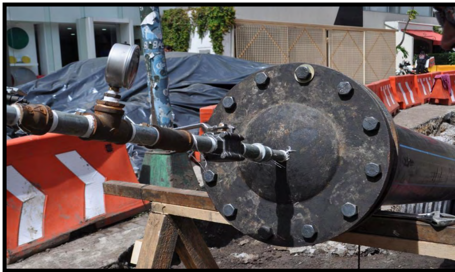
Imagen 23. Arreglo de tubería y manómetro.
