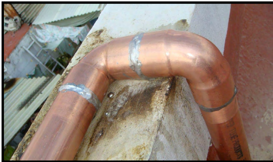
Imagen 12. Tubería de cobre de la red de agua de servicio.
