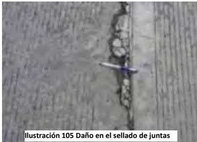
Ilustración 105 Daño en el sellado de juntas
