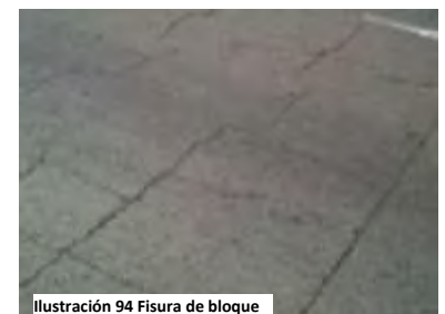
Ilustración 94 Fisura de bloque
