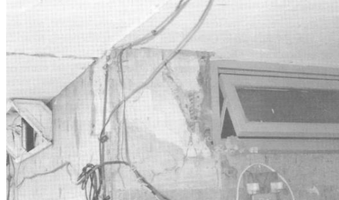
Figura 2.33 Daño en columnas del cuarto de control por efecto de columna corta
