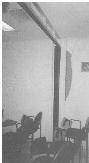
Figura 2.34 Daño en muros divisorios del Edificio de Investigación y Capacitación
