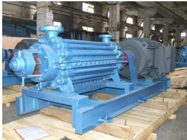
Fig. 1.30 Bomba de agua de alimentación http://buildingsdatabook.eren.doe.gov
