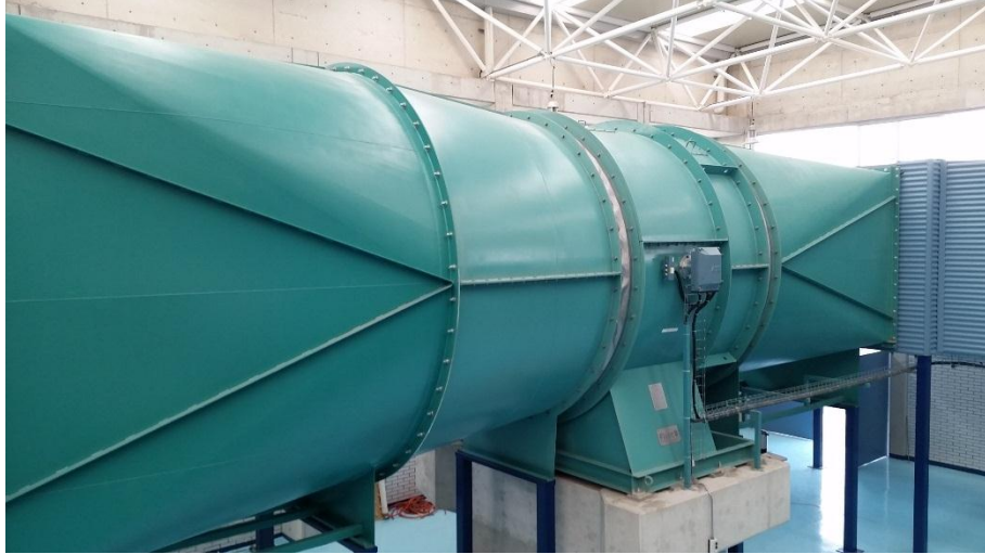
Figura 5: Imagen del ventilador del túnel de viento
