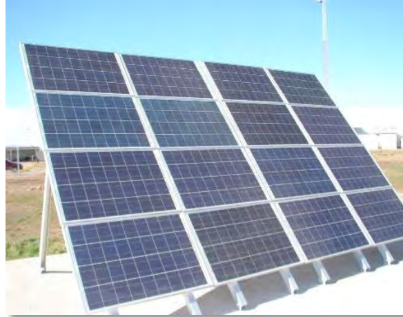
Figura 2.1 Generador fotovoltaico formado por 16 paneles [Fuente: Instituto de Investigaciones Eléctrica, (IIE)]
