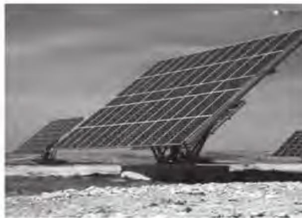
Figura 1.14 Sistema de seguimiento para un generador conectado a la red [Fuente: Corporativo Premier Power]
