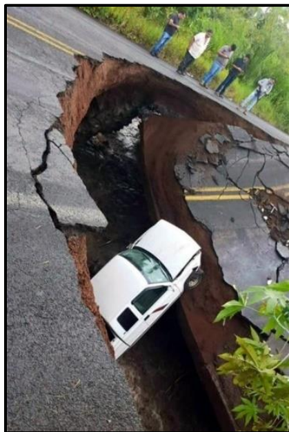
Figura 1.6. Falla de carretera en Michoacán durante el paso del Huracán Patrice (2015).
