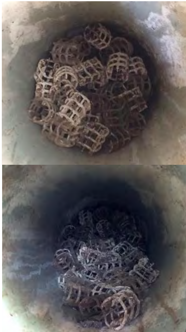
Figura 8.1. Azufre elemental depositado en el material de empaque de la columna de desorción
