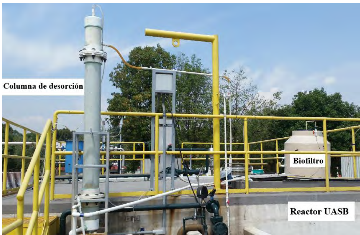
Figura 4.3a. Sistema para la desorción y remoción biológica de metano y sulfuro de hidrógeno disueltos en el efluente del reactor UASB
