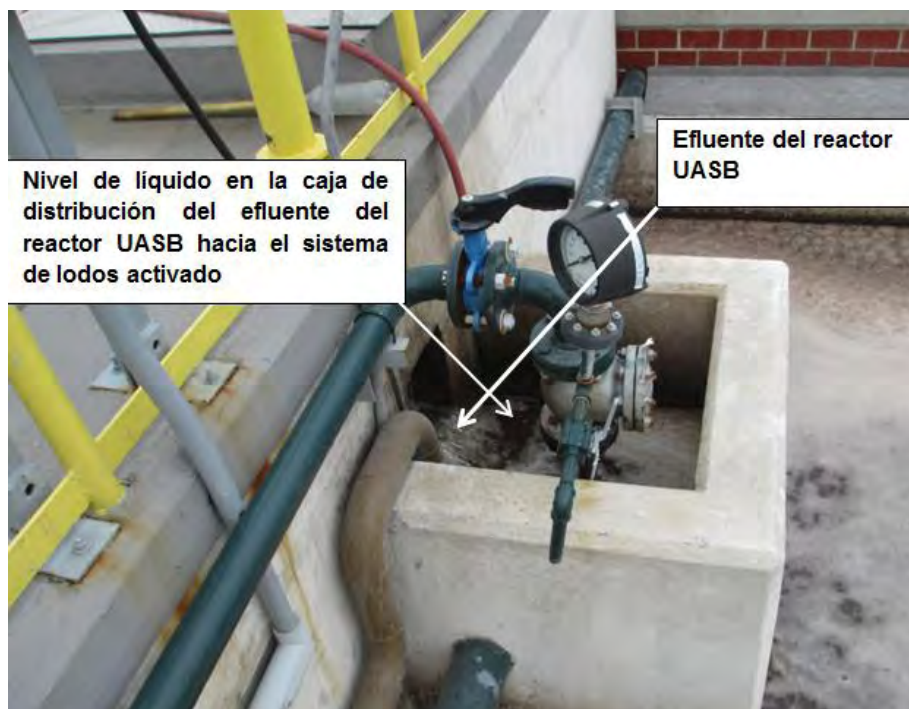
Figura 4.1. Salida del efluente del reactor UASB hacia al sistema de lodos activados
