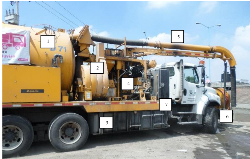
Figura 1.5. Partes principales del equipo hidroneumático
