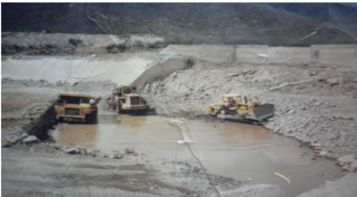
Foto 15. Construcción de la cortina de la presa, autor y año desconocido, trabajo de campo, diciembre, 2014.
