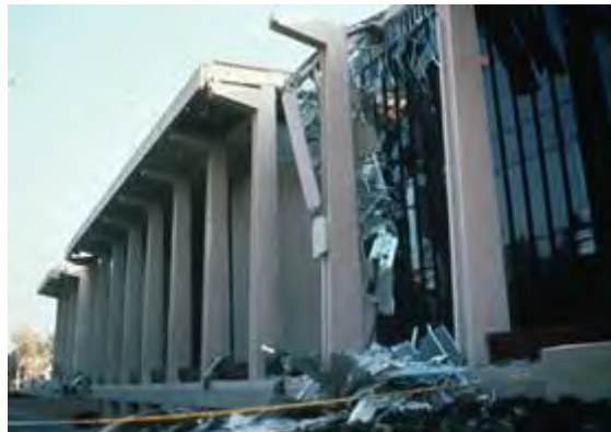
Figura 1.8 Daño en sistema de fachada Librería Oviatt (CSUN, 2014).
