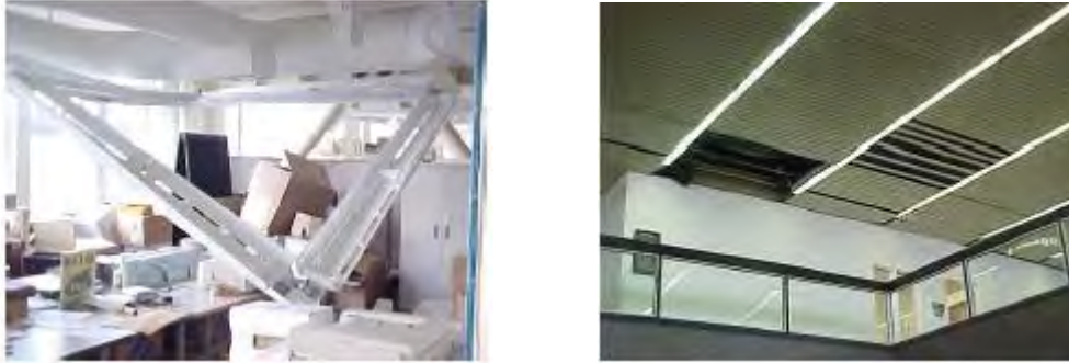
Figura 1.4(a) Caída de plafones con luminarias edificio Starbucks, (b) Caída de sistema de techo aeropuerto Sea-Tac (Filiatraurlt et al. , 2002).
