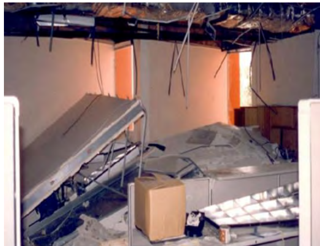
Figura 1.9 Daño en sistema de techo durante el sismo de Northridge (FEMA E 74,2012).
