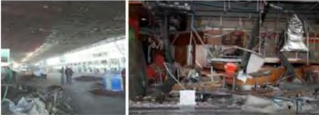
Figura 1.2 Daño no estructural en el aeropuerto de Santiago de Chile (Miranda, 2012).
