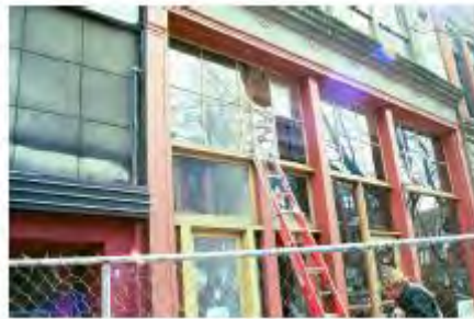
Figura 1.5 Fractura de vidrios Pioneer Square (Filiatraurlt et al. , 2002)
