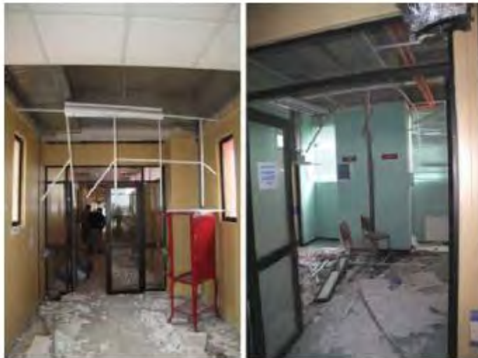
Figura 1.3 Daño no estructural en el aeropuerto de Santiago de Chile (Miranda, 2012).
