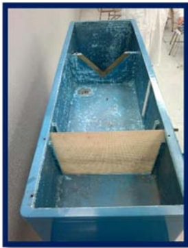
Figura 46: Depósito de agua antes de la rehabilitación.
