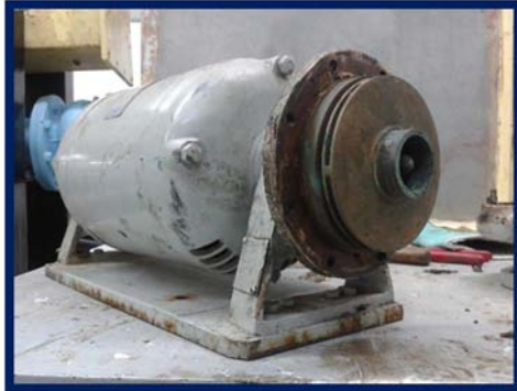
Figura 24: Condiciones en las que se encontró el motor y la bomba.
