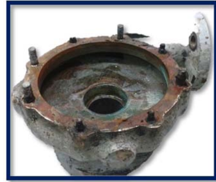
Figura 27: Condición inicial de la carcasa de la bomba.
