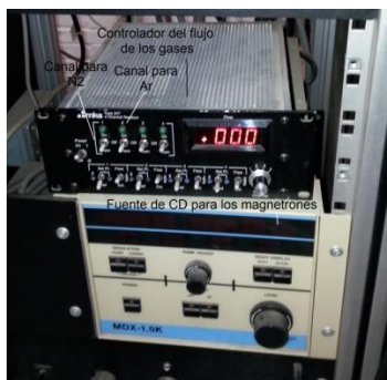
Figura 24 Controlador de flujo de los gases y fuente de CD empleadas en el depósito
