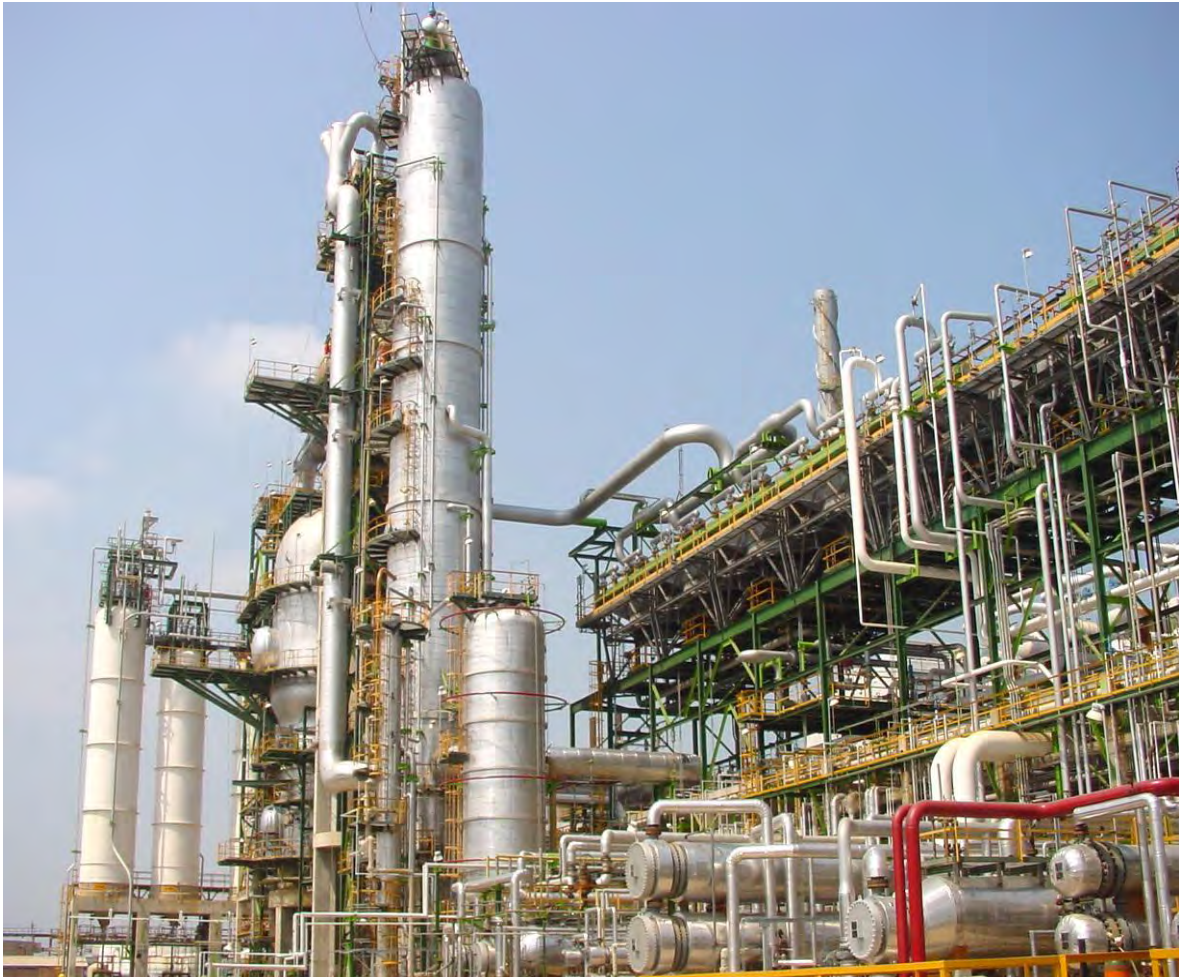
Figura 3. Planta Catalítica II donde se encuentran los cambiadores de calor enfriados por aire y principales equipos que hacen funcionar a la planta.
