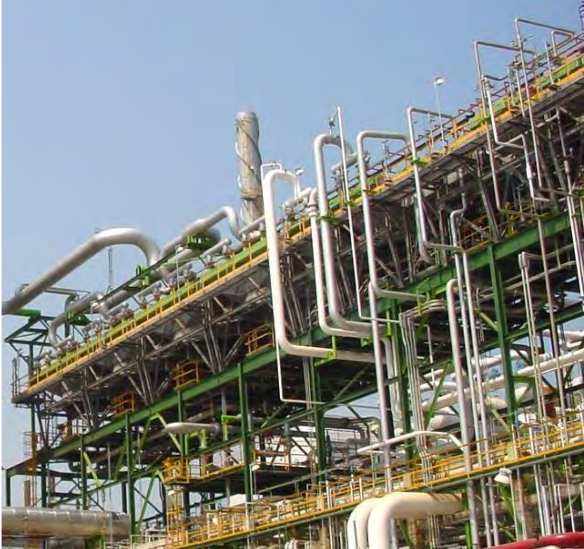
Figura 8. Imagen física de cambiadores de calor enfriados por aire en operación.
