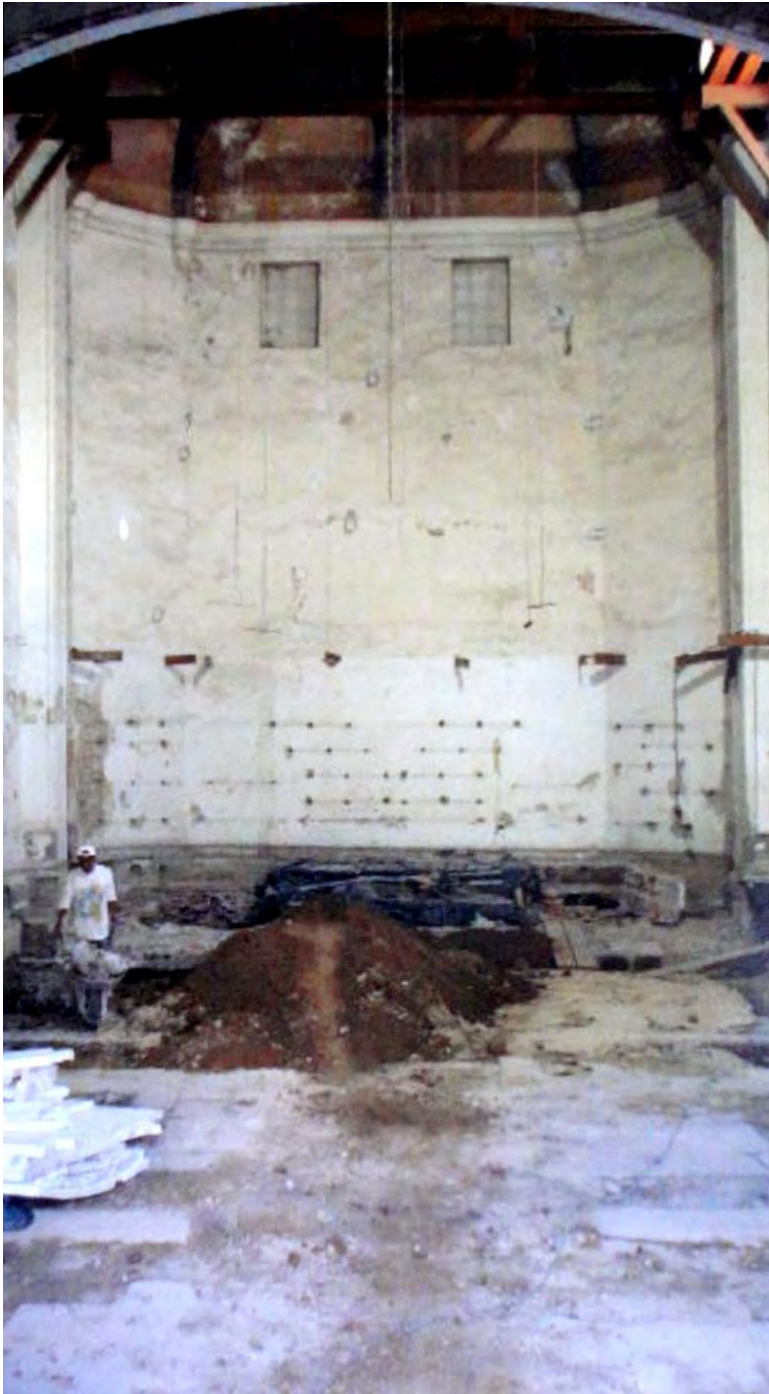
Vista anterior de la nave tomada desde el sotocoro durante el proceso de restauración, 2004. 469
