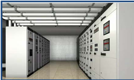
Cuarto de control satelital
