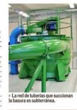
La red de tuberías que succionan la basura es subterránea.
