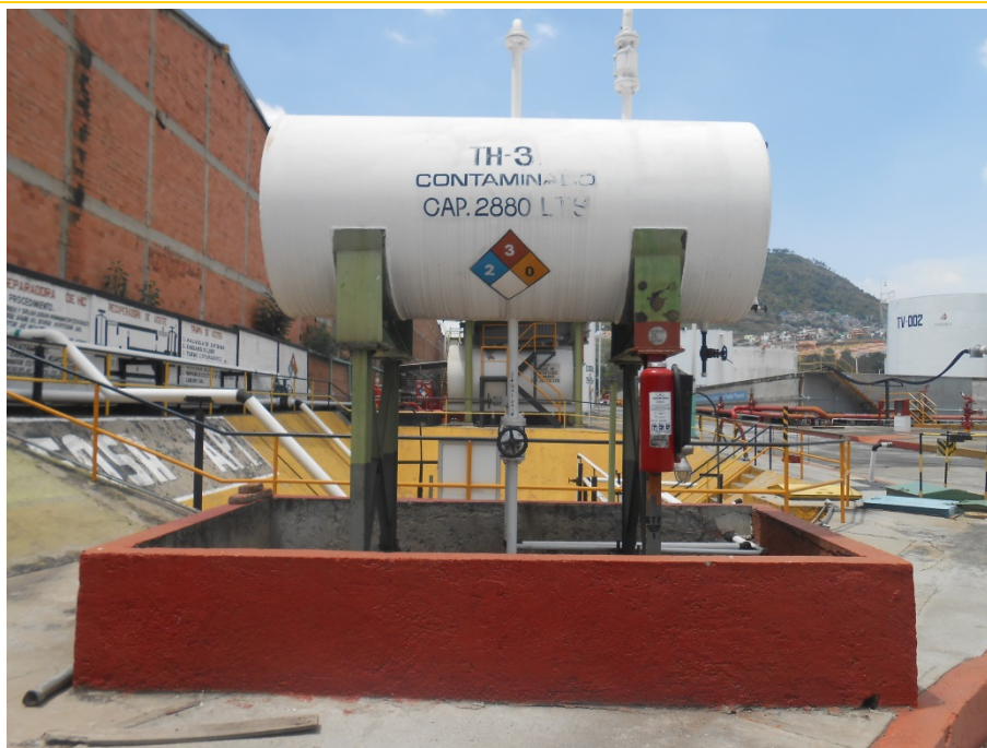
Figura 2.3 Tanque de recuperados
