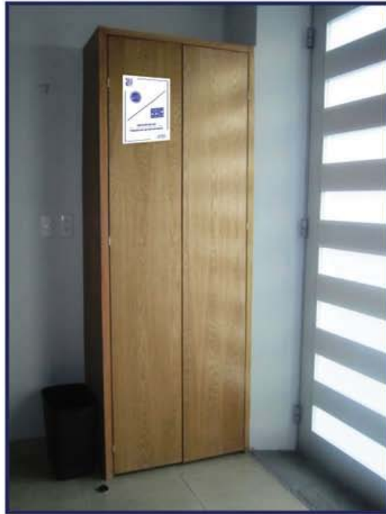
Imagen 238: MEDIDOR DE LUZ TABLERO DE INTERRUPTORES
