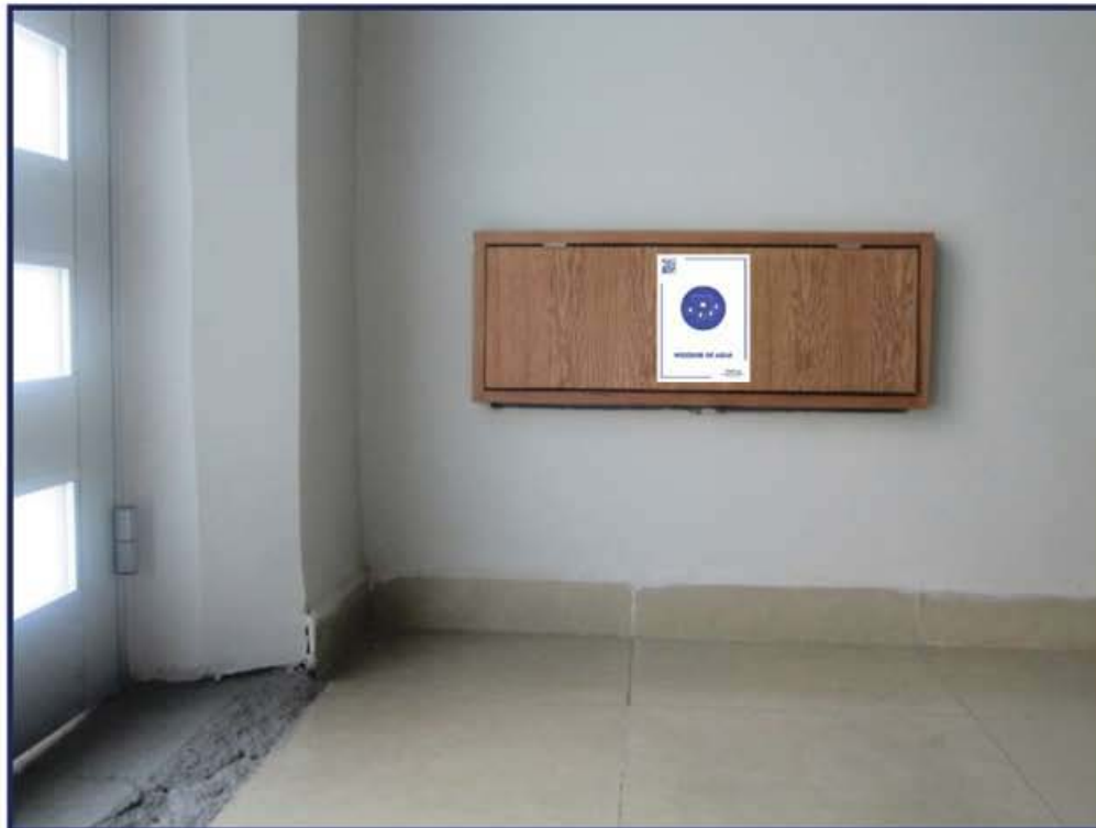
Imagen 237: MEDIDOR DE AGUA
